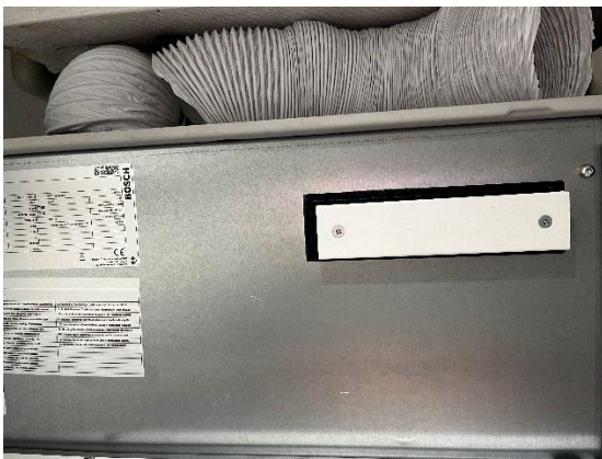
Rengöring av filter (värmepanna)
